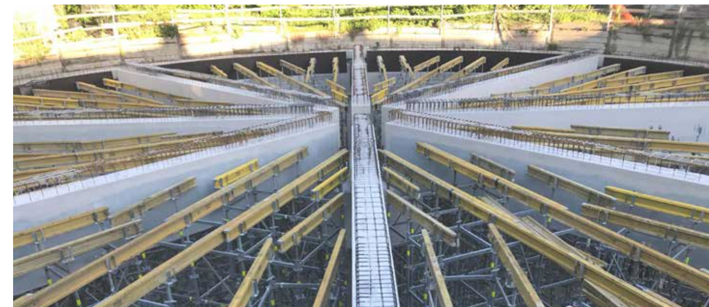
Bassin d'orage Bien-Faire - Stormbekken Bien-Fairestraat
