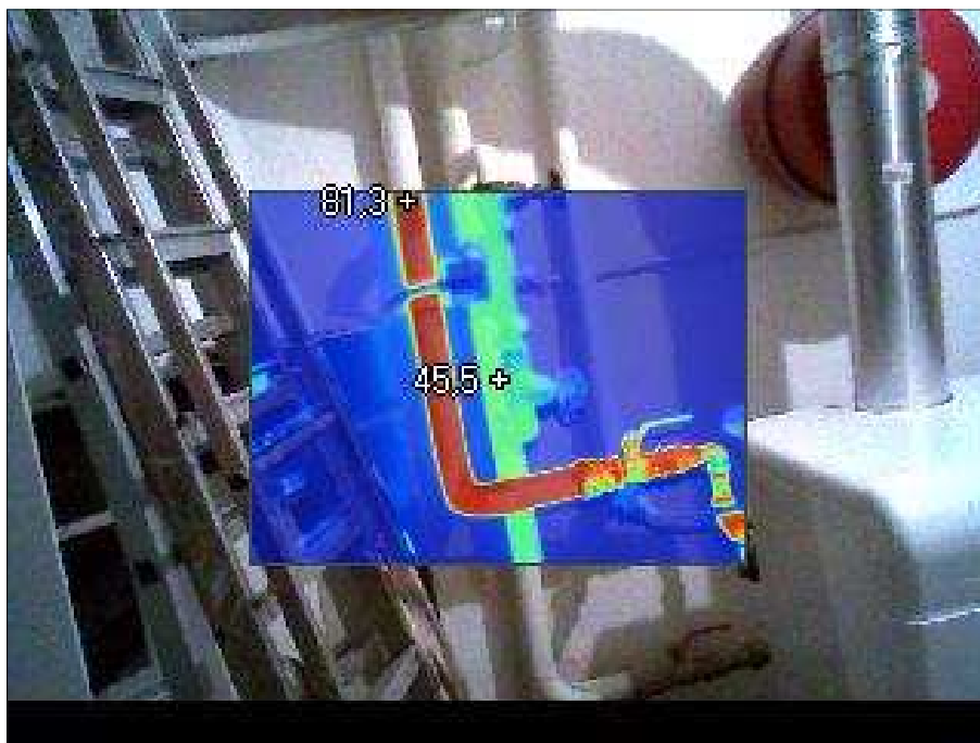
Niet geïsoleerde verwarmingsbuizen.
